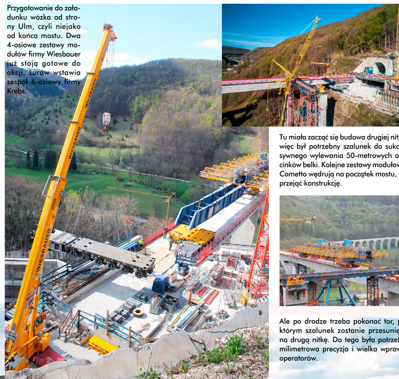
Ładunek o długości 85 m i masie 350 t mknie z zawrotną prędkością 0,5 km/h po pierwszej nitce mostu.
