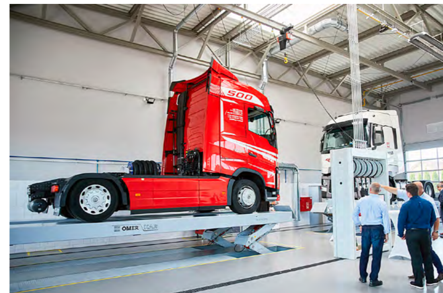
W nowej części hali zainstalowano podnośniki nożycowe o nominalnym udźwigu 20 i 25 t (przy symetrycznym obciążeniu 30/38 t). To nowa konstrukcja OMER Kar m.in. bez płyt ślizgowych na posadzce, dzięki czemu łatwiej przemieszczać się wokół obsługiwanego pojazdu
